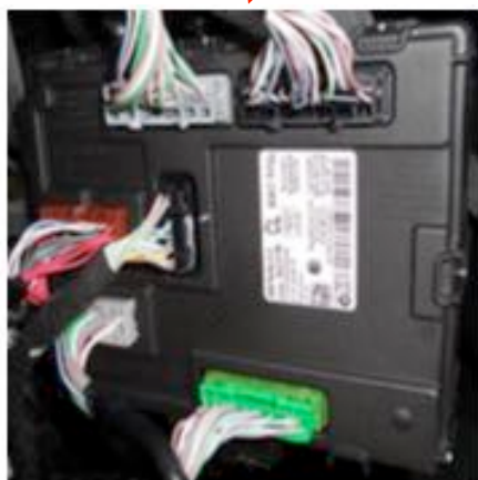
Vue de la centrale BCM
